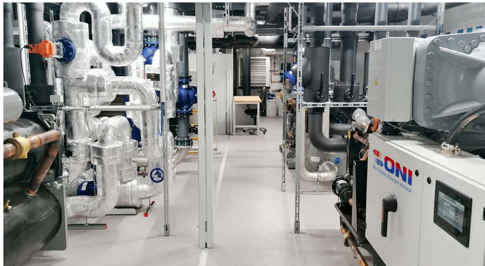
Teil einer energieoptimierten Kühlanlage mit Wärmepumpentechnologie für einen bedeutenden Verpackungshersteller in Österreich.
